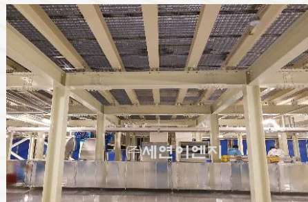
ACCESS FLOOR 하부
