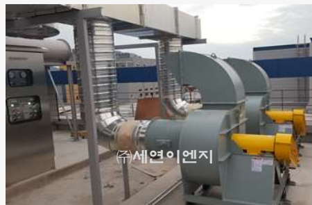
열배기 FAN 설치
