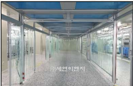
CLEAN BOOTH 설치
